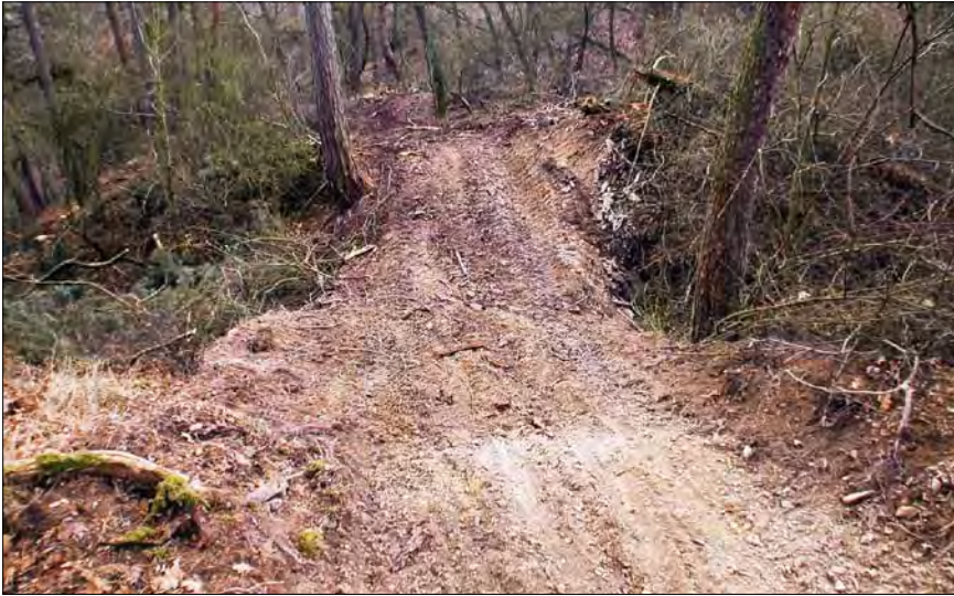
Obr. 150: Libštejn, k. ú. Liblín, okres Rokycany. Předsunutá bašta hradu poškozená lesními pracemi. Průjezd stromy vytožený těžkou technikou vede přes příkop bašty. Foto P. Sokol 2005.
