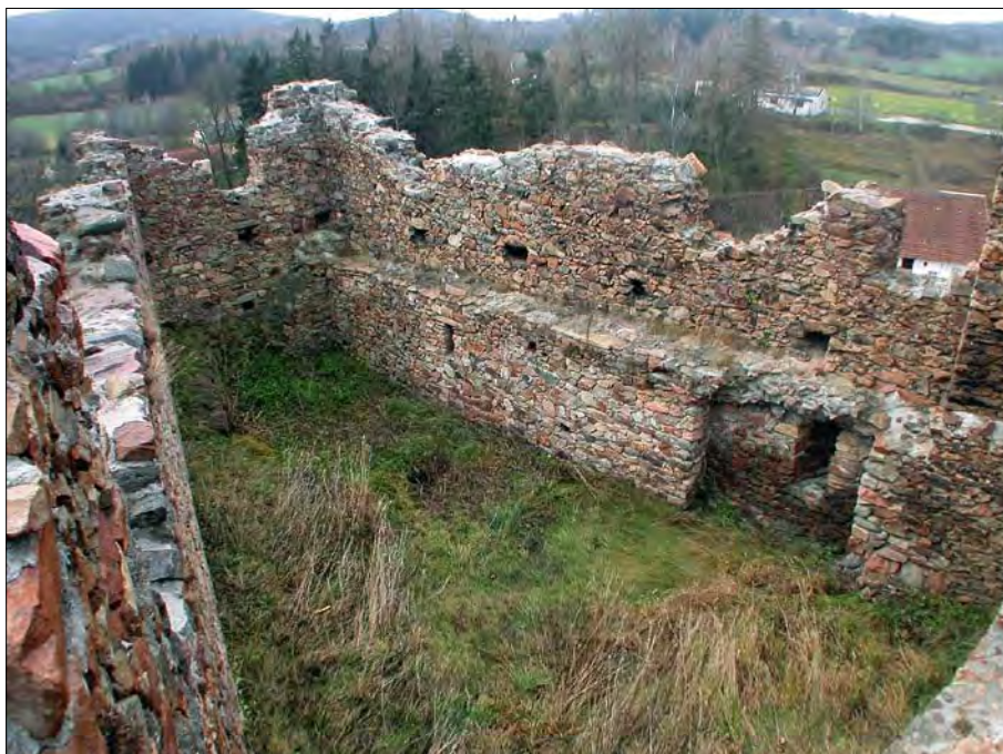
Obr. 25: Zvolekov, okres Klatovy. Ruina budovy tvrze na lichoběžníkovitém půdorysu, situované na skále při okraji intravilán obce. Foto P. Sokol 2006.
