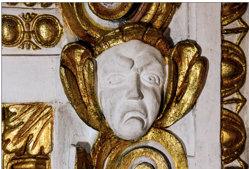
Obr. 35. Zlacení bronzí v olejovém pojiu materiálově ani výtvarně neodpovídá původnímu renesančnímu zlacení. Nevhodná, málo propustná a nevratná úprava způsobuje poškozování původní štukové výzdoby. Na řadě míst je navíc zlacení zčernalé oxidací nebo jsou patrné korozní produkty mědi, které kontaminují originální části. (SZ Jindřichův Hradec, Rondel, detail zlacení s okrovou patinací provedený v rámci zásahu v 80. letech 20. stol. Foto: Petr Kuneš)
