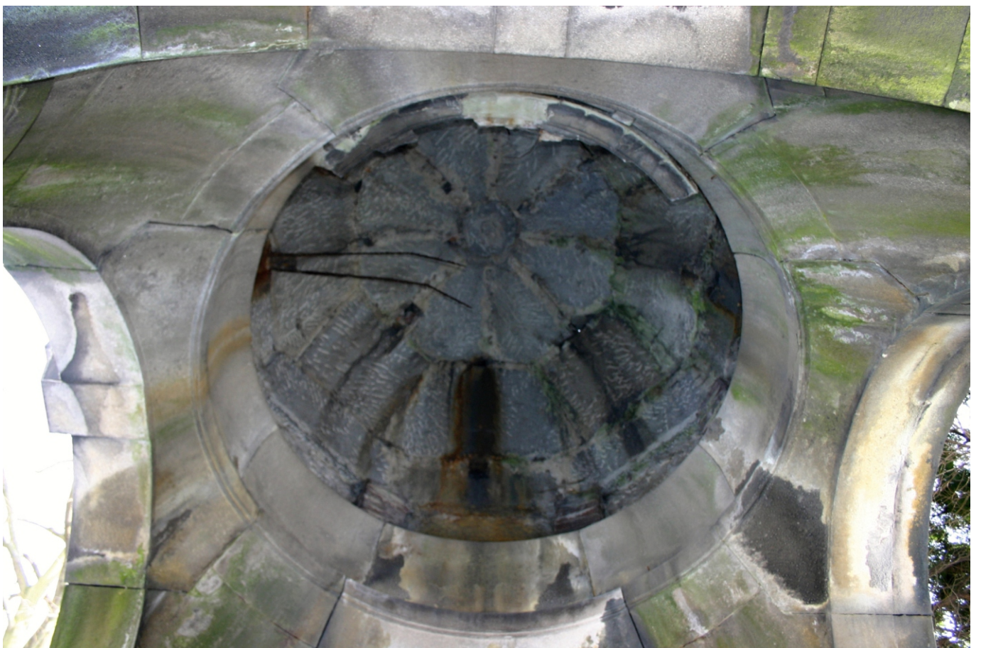
pohled do kopule od severu, západně (vlevo) kovový prvek o dvou drátech, snad zbytek ztužujícího táhla
