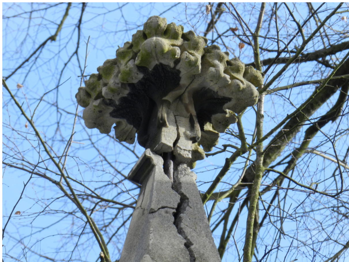
křížová kytká betonové fiály nad severovýchodním nárožím, v prasklině je vidět kovová výstuž
