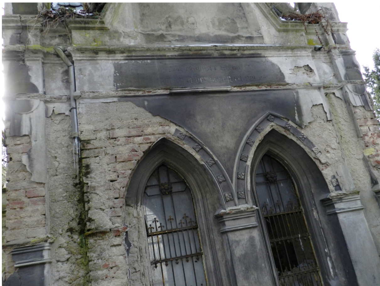
ve štítu datace 1910, ve vlysu římsy již nečitelný nápis: „... nder ist hat ... verwesen ist ein ...” průraz dešťových svodů skrz atiky bočního štítu nad římsou, sdužené okno východní fasády
