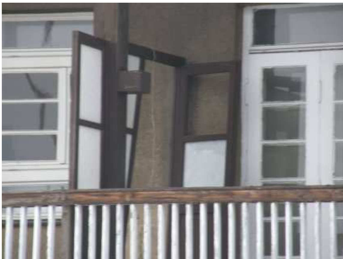
fotografie - detail zábradlí, sloupu a dělicí stěny terasy patra: zdroj: Ondřej Wünsch (2008)
