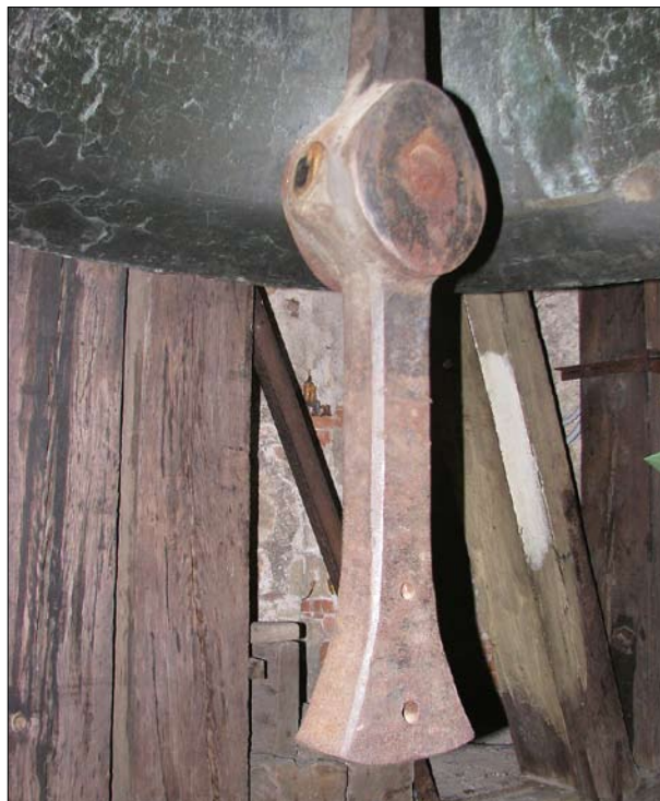
Město Touškov, okr. Plzeň-sever, zvon z r. 1601. Jednoosé srdce s doplněnou zátěží na bocích pěstí (foto P. Vácha, 2011).
