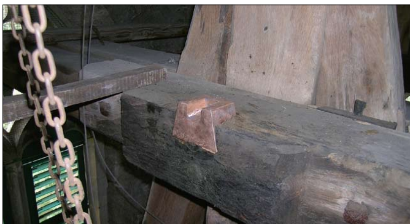
Poděbrady, okr. Nymburk, kostel Povýšení sv. Kříže. Bronzové kluzné ložisko, zhotovené podle původního (foto P. Vácha, 2007).
