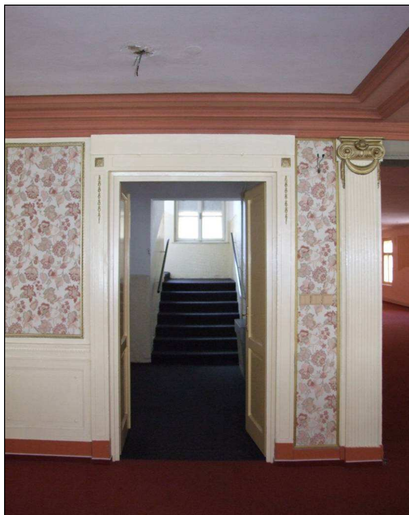
Františkovy Lázně, Národní třída č.p. 6, hotel Zlatý anděl – výzdoba stěn na galerii
