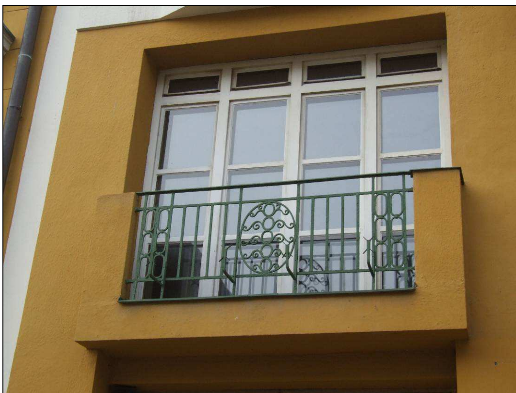
Františkovy Lázně, Národní třída č.p. 6, hotel Zlatý anděl – detail balkonu na hlavním průčelí
