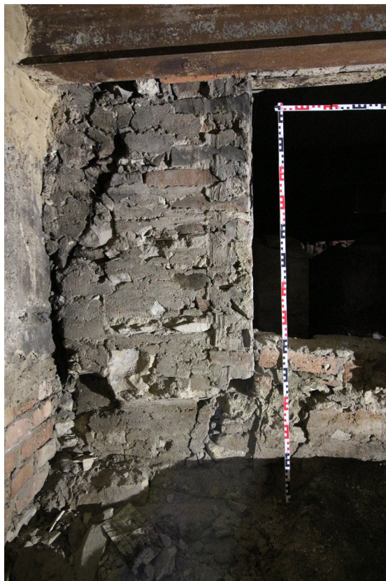
134c_JV kout s otisky čel trámů v nárožní vazbě a otisk stojky dřevěné zárubně vstupu_LB IMG_1146
