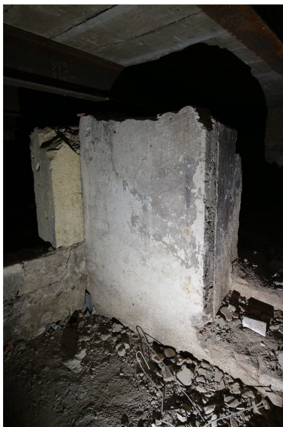
130d_vstup do 1.32 s otiskem po dřevěné zárubní v omítce_LB IMG_1101
