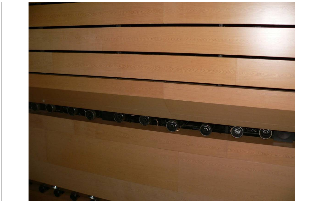
Detail, svítidla v podhledu foyer, foto 2012.
