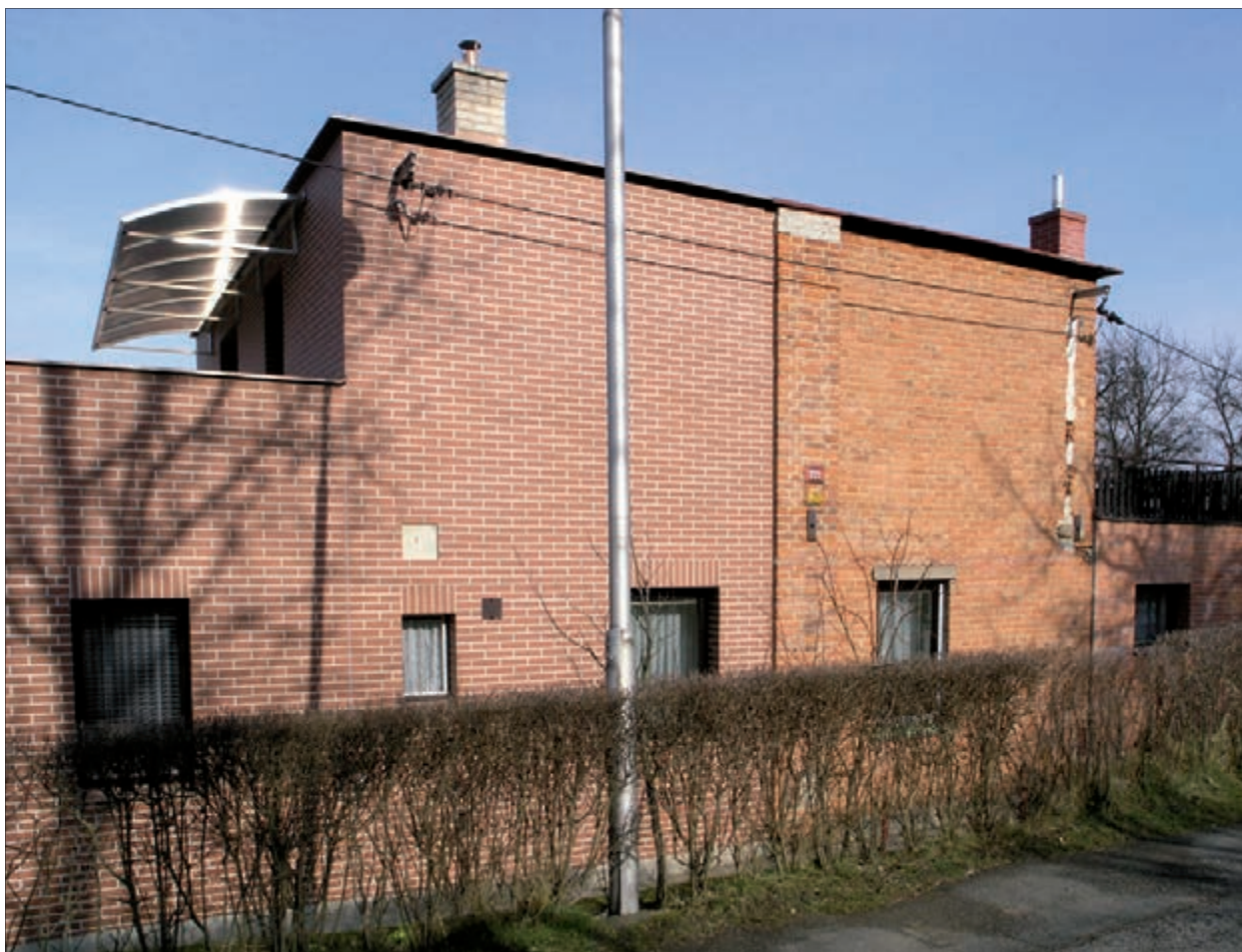
Srovnání originální a nově obložené fasády batovského domku. Nový obklad má odlišný barevný odstín, příliš zdůrazněné spáry a překrývá i charakteristické betonové překlady oken.
